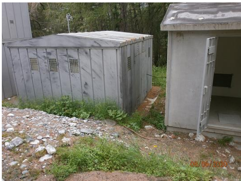
box sala quadri in servizio
