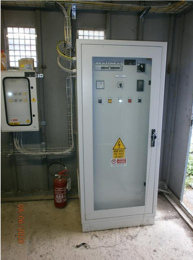
Quadro comando Pompa 1
